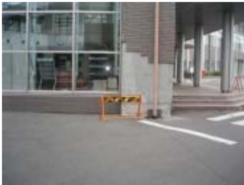
写真 4: 壁タイルの剥落(栗原市庁舎)
