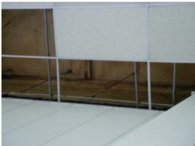
写真 9: 根白石温水プールの天井落下部分
