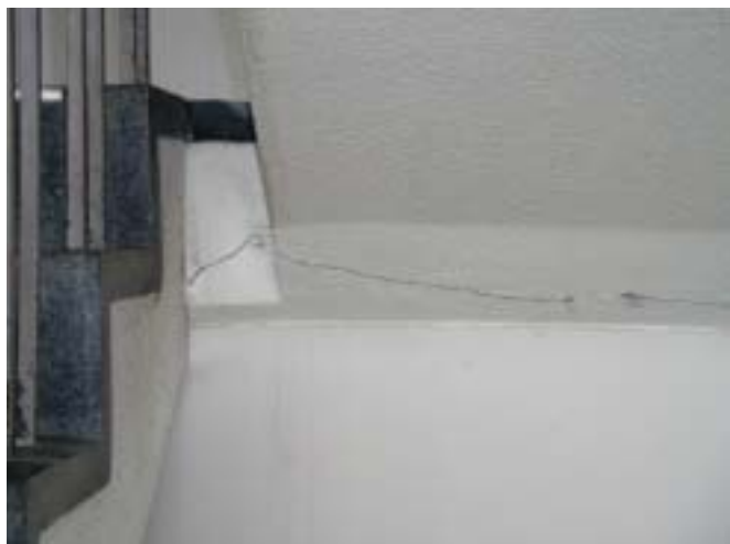
写真 3: 川崎町役場 2 階の階段部分の被害
