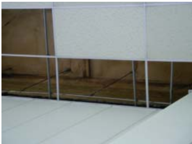
写真 9: 根白石温水プールの天井落下部分
