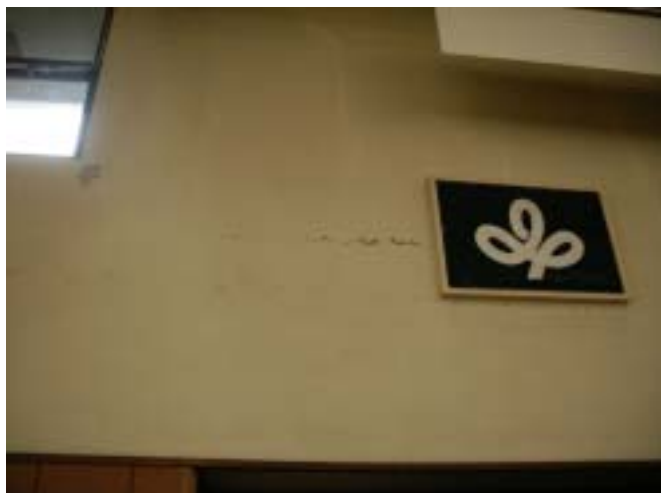
写真 13: 宮城県武道館の壁のひびわれ
