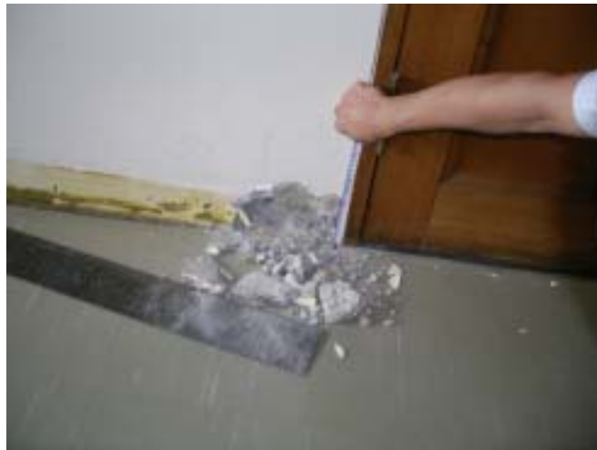
写真 2: 川崎町役場 3 階の RC 壁の被害
