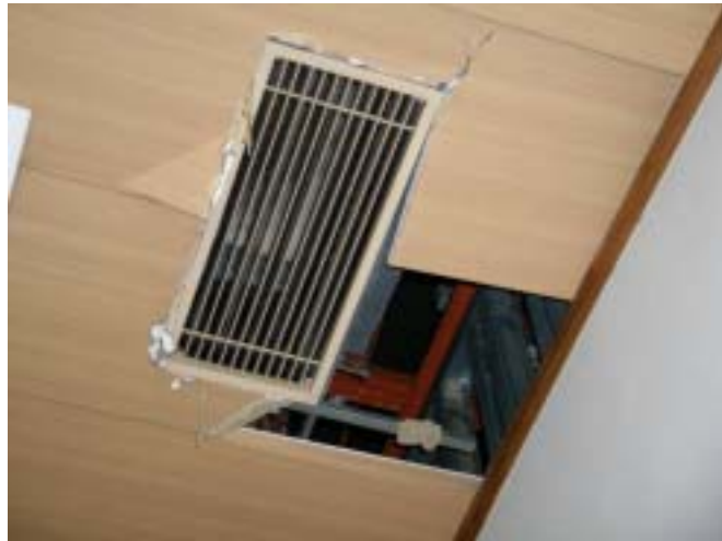
写真 12: 宮城県武道館の天井の落下
