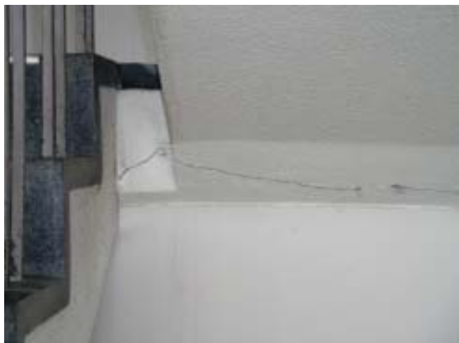
写真 3: 川崎町役場 2 階の階段部分の被害
