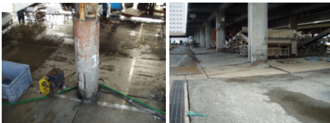
写真 19 中央卸売市場での柱脚の被害 （中央区長浜 3 丁目）
