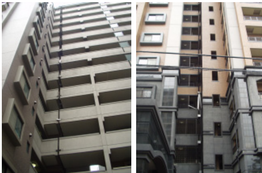
写真6 エキスパンション・ジョイントの被害（中央区今泉2丁目）
