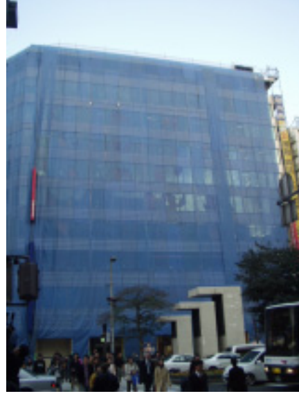
写真4 多数のガラスが破損 (中央区天神1丁目)
