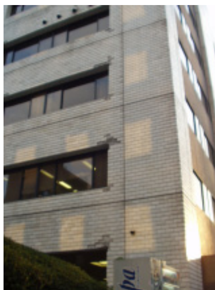
写真 2 外壁タイルのはく落 (中央区大名 2 丁目)
