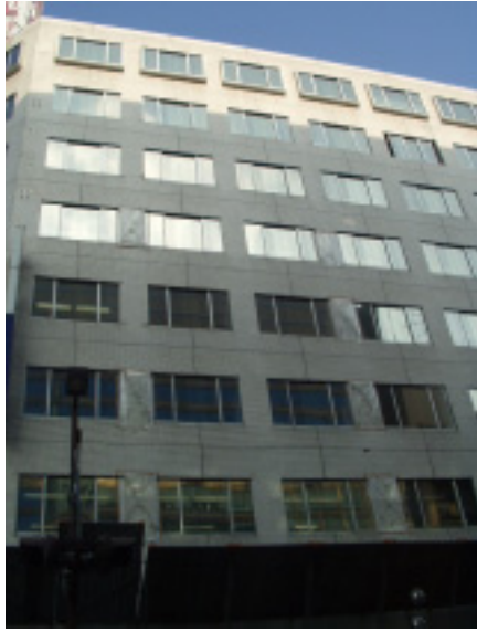
写真3 外壁のせん断ひび割れ (中央区大名2丁目)
