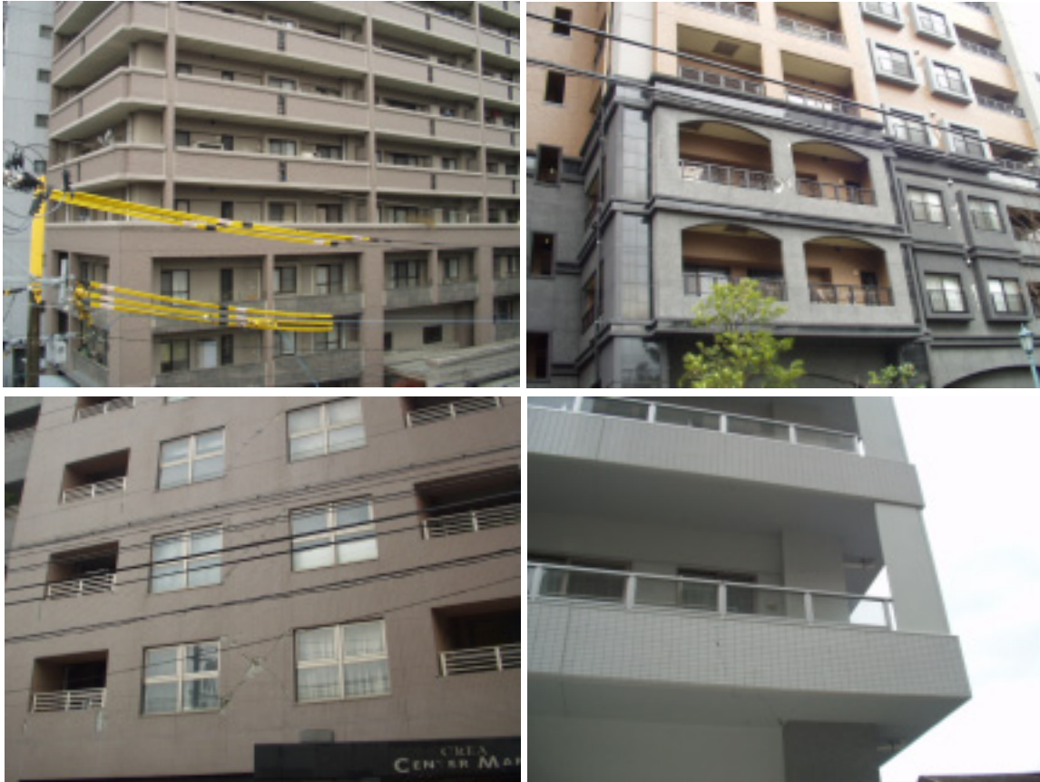
写真5 外壁のせん断ひび割れ (中央区今泉2丁目)
