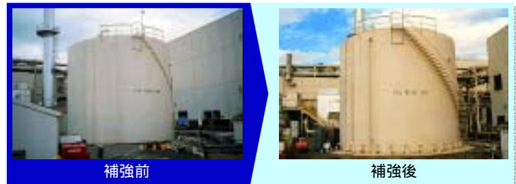
【Photo 4】 消火用水タンク 固定補強
